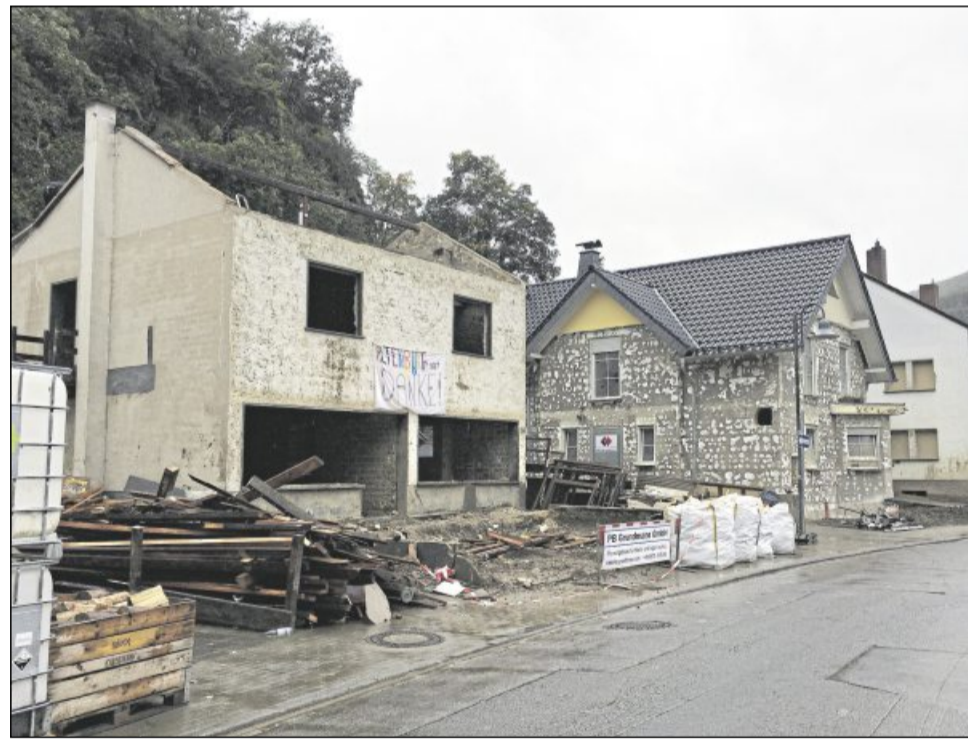
Hier wohnt niemand mehr, die Häuser in Altenburg sind entkernt.
